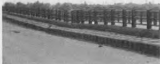
写真-4 中央ヒンジ部の変形による路面の陥没状況 (出典：経済産業省)
