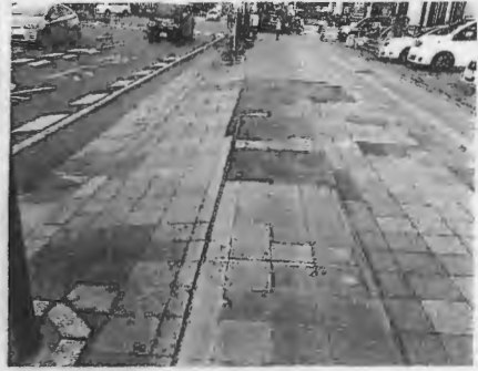
写真-3 歩道 舗装凸凹
