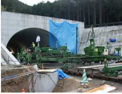
トンネル内のコンクリート舗装 スタート地点の機械セット
