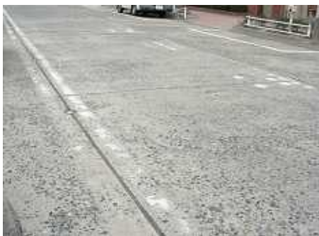
路面がよく使い込まれて粗骨材 (Max40mm・当時は玉砂利を使用) が露出しているコンクリート舗装 (国道 35 号 佐賀県有田市)
