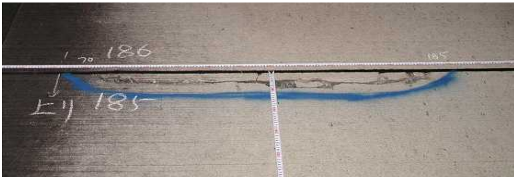
目地部のひび割れが進展 (上、下の写真とも)
