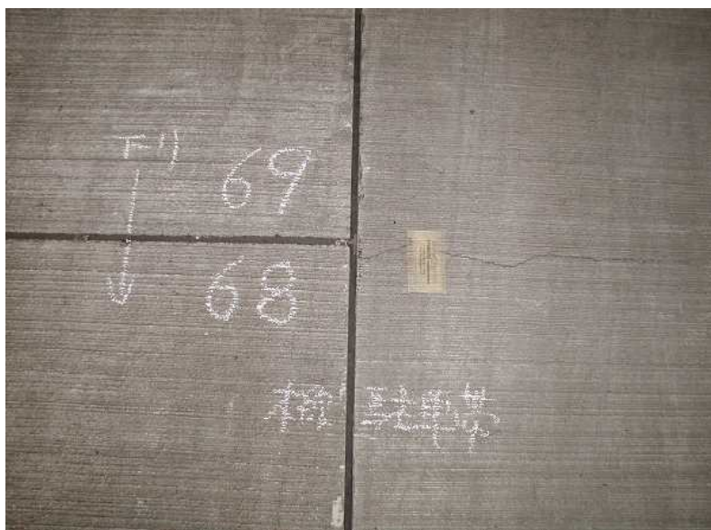
非常駐車帯の目地割り不適切（設計時）によるひび割れ
